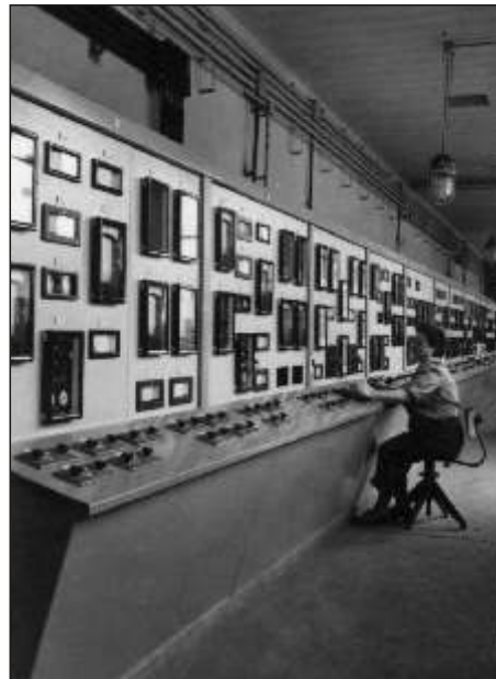
Bild 8 Geschlossene Meßwarte mit pneumatischer und elektrischer Fernverstellung von Ventilen in der Essigsäureanhydrid-Anlage F 29, um 1950
