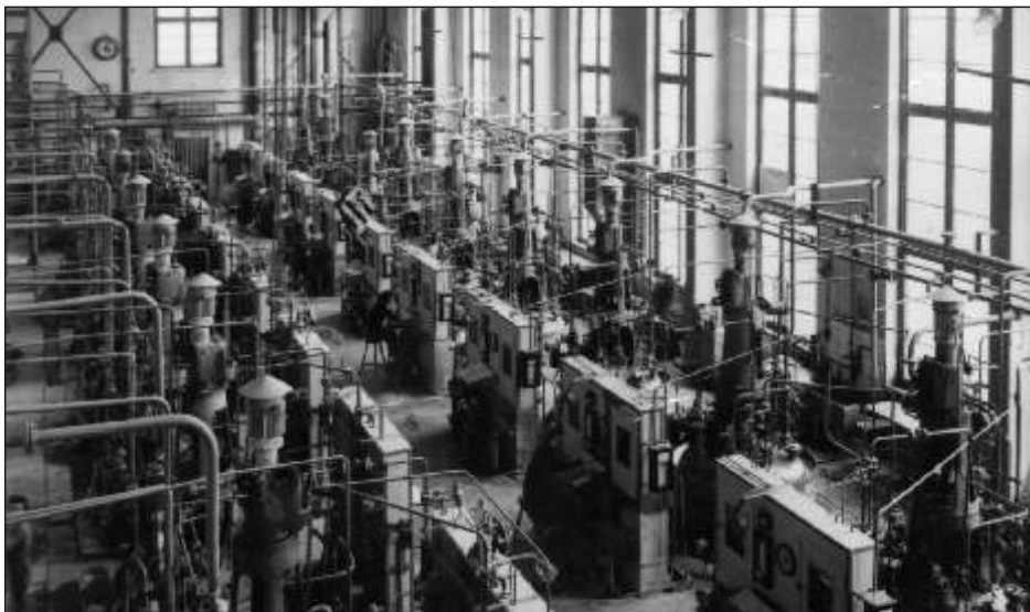
Bild 5 Bedientafeln in der BUNA-S-Aufarbeitung A 44, um 1940, noch in unmittelbarer Sichtkontrolle der Prozeßabläufe
