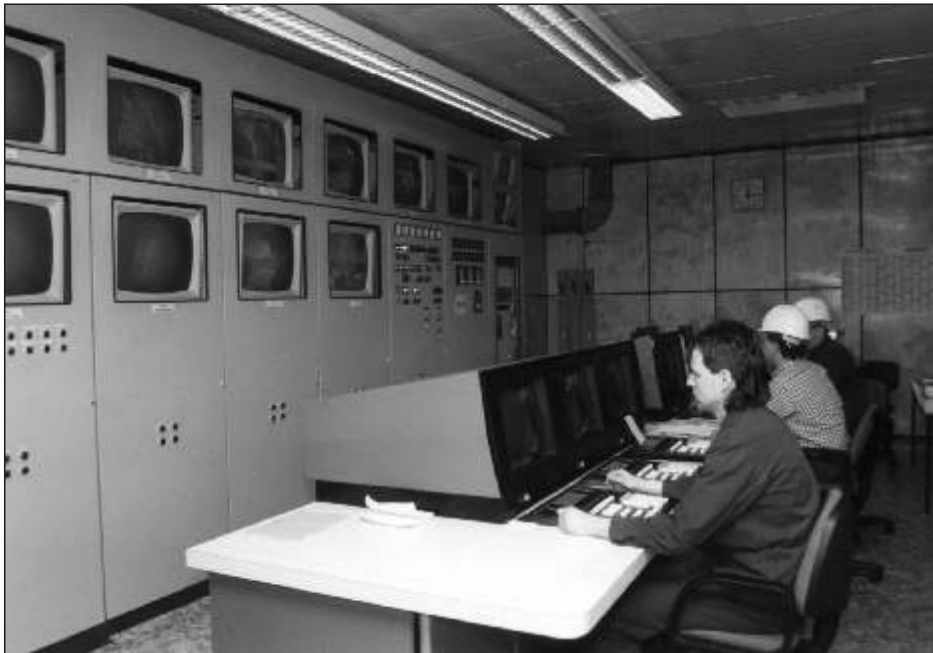
Bild 12 Moderne Meßwarte mit Prozeßleitechnik und Videoüberwachung von Anlagenabschnitten in der Kaltkautschukfabrik D 92, um 1988
