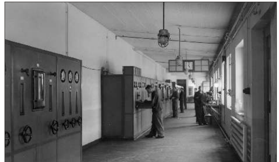
Bild 7 Geschlossene Meßwarte noch mit Handrädern zur Ventil-Fernverstellung in der Styrenanlage C 53, um 1940. Einsatz von nicht explosionsgeschützten Geräten ist möglich
