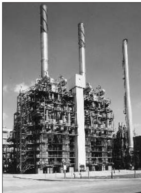
Bild 19 Neue Spaltöfen der Olefinpyrolyse Böhlen
