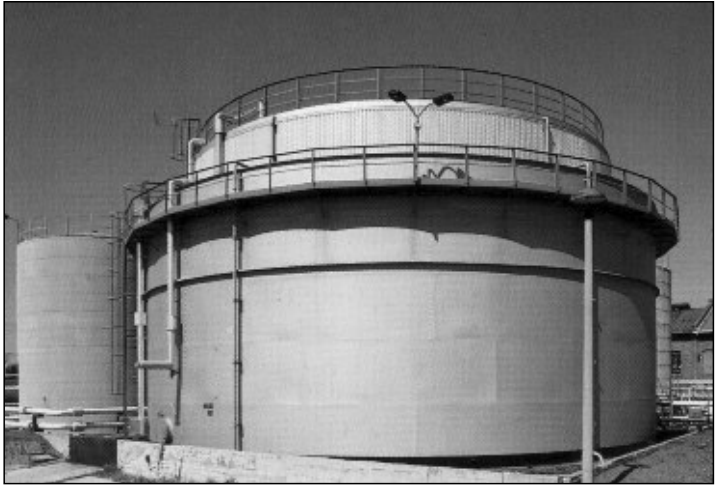
Bild 30 Rohstofftanklager – 3.200 m 3 Tank
