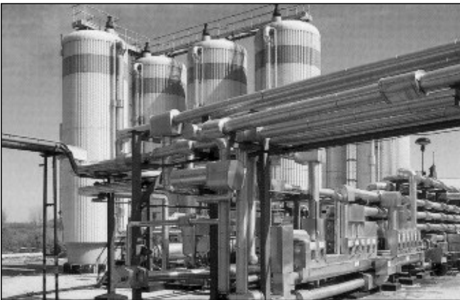
Bild 35 Fertigprodukttanklager im Mitteldeutschen Bitumenwerk, Standort Gerstewitz
