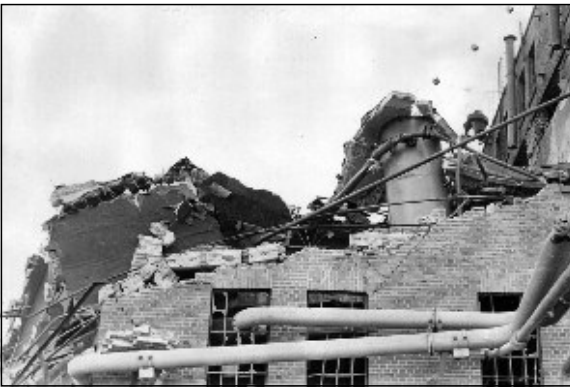
Bild 24 Nach der Explosion in der Lösungsmittelrückgewinnung Köpsen – Südseite
