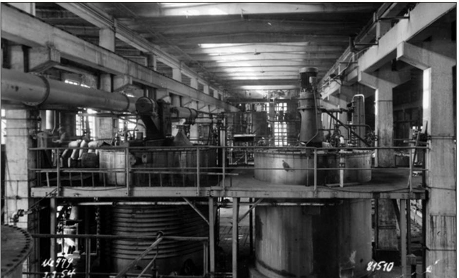
Bild 24 Anlage zur Oximierung im Bau 979
