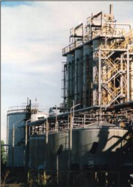
Bild 5 Hydrolyseanlage mit den 8 stehenden Reaktoren aus Titan, hinten links der 300 m 3 HAS-Tank, im Vordergrund die drei 125 m 3 AHS-Tanks, 1997
