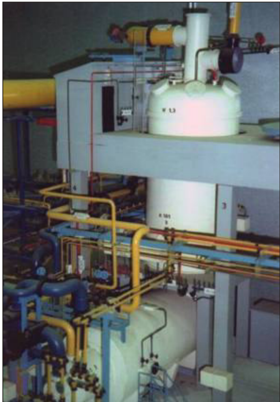
Bild 10 Erdgasgestützte \text{H}_2\text{S} /Schwefelverbrennungsanlage mit Brennkammer, Primärabhitzeteil und Analysenhaus nach dem Aufbau durch IMO Merseburg Bau A 384, um 1997 (vgl. Bild 8)
