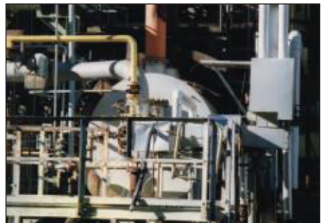
Bild 3 Erdgasgestützte Schwefelverbrennungsanlage 1 mit H 2 S/Schwefel-Brennersystem in A 384, 1997
